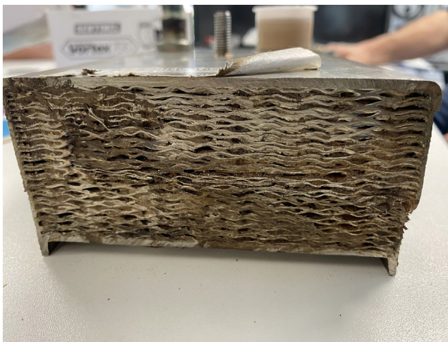
Les échangeurs des Pac peuvent être totalement obstrués quelques mois seulement après leur installation. © Sentinel
